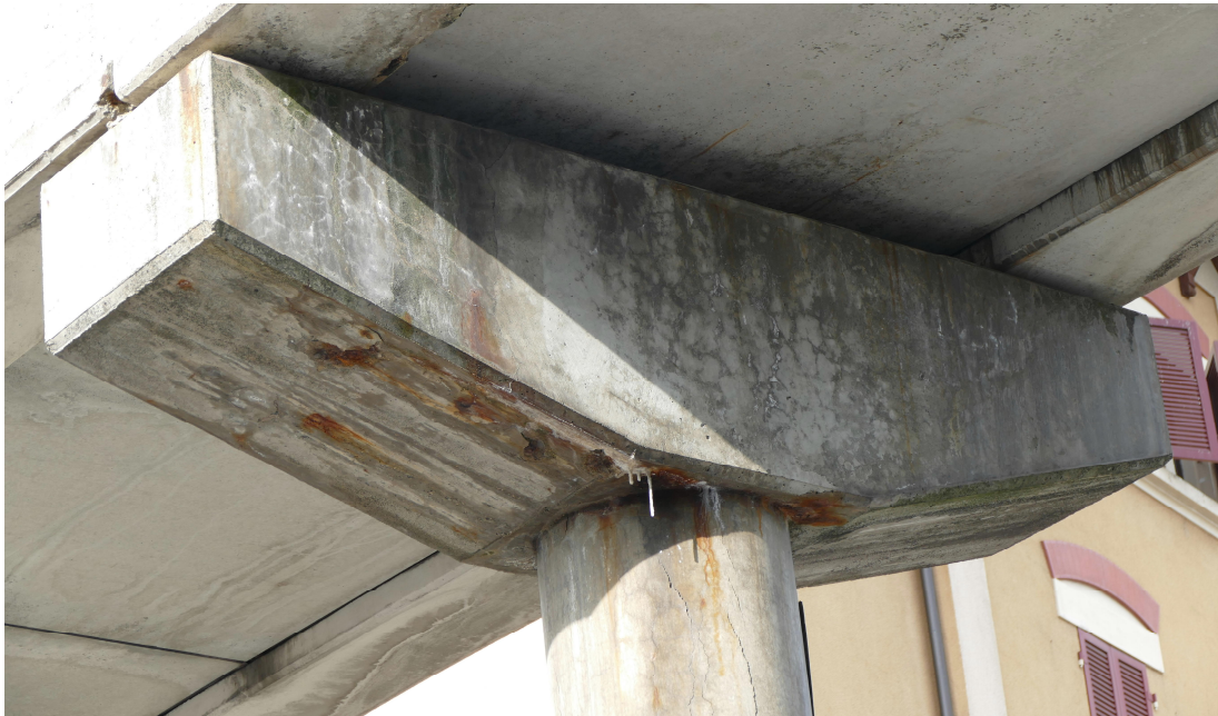
Figure 2-1 : Tête de pile n°1 avant assainissement
