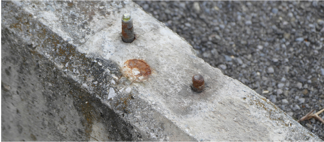
Figure 2-10 : Tiges filetées avant travaux d'assainissement
