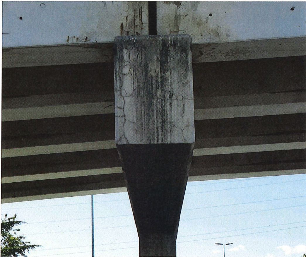
Figure 2-8 : Dégradation de la tête de pile n°2
