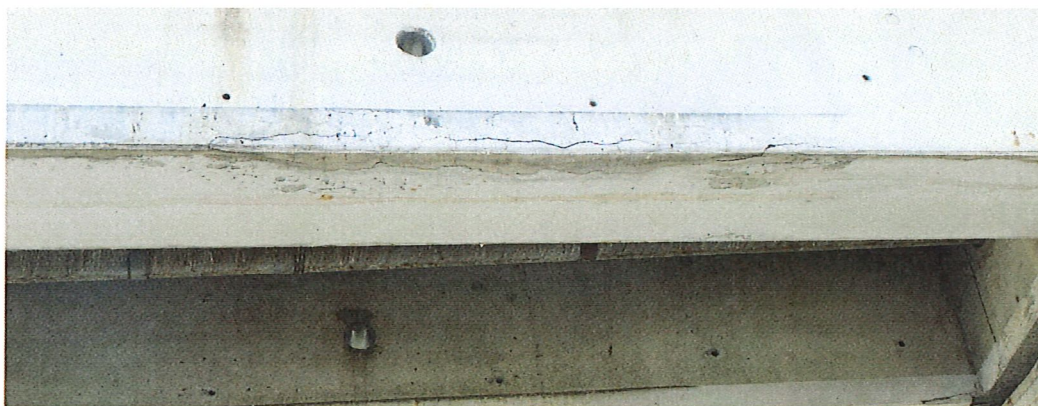
Figure 2-1 : Fissuration des poutres préfabriquées de bord
