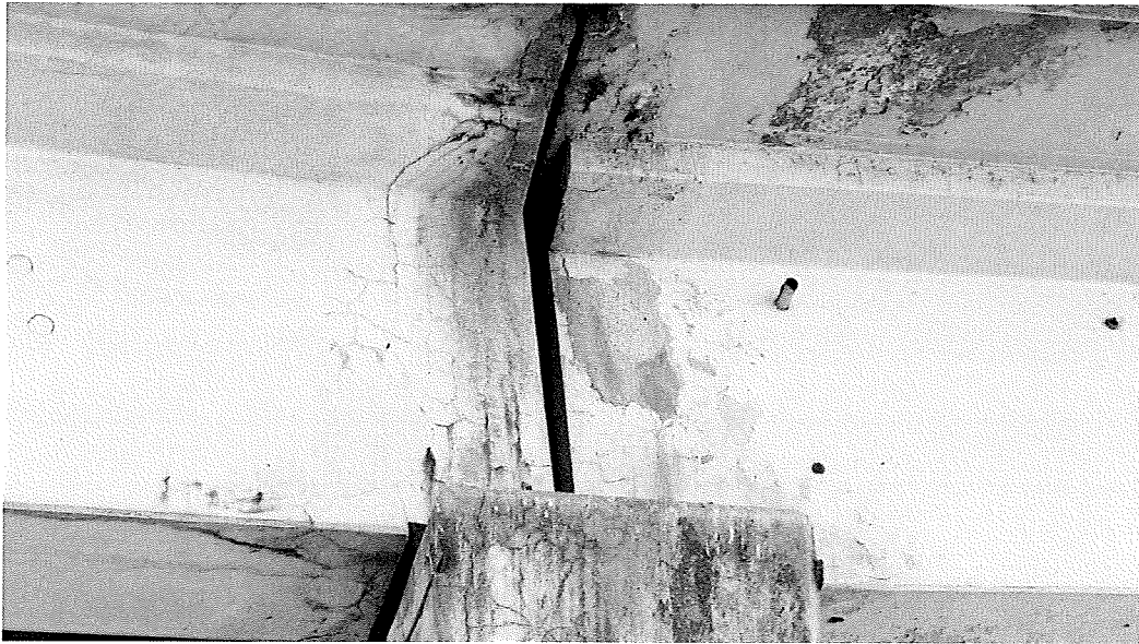
Figure 2-3 : Fissuration des poutres sur appui
