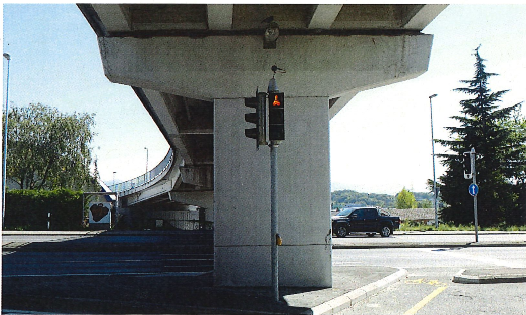
Figure 2-9 : Dégradation de la pile n°3
