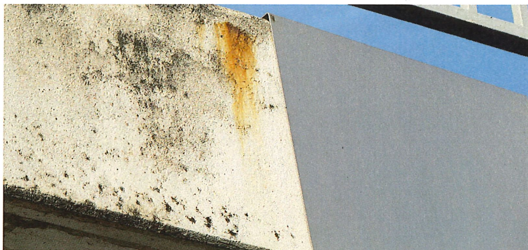
Figure 2-6 : Rouille de l'armature
