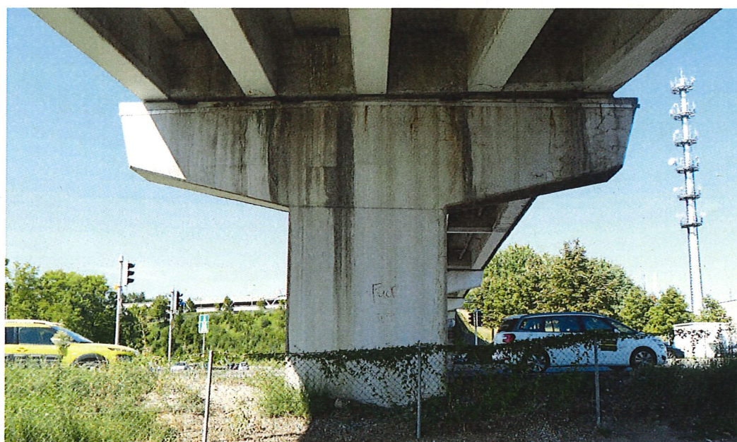
Figure 2-7 : Dégradation de la pile n°2
