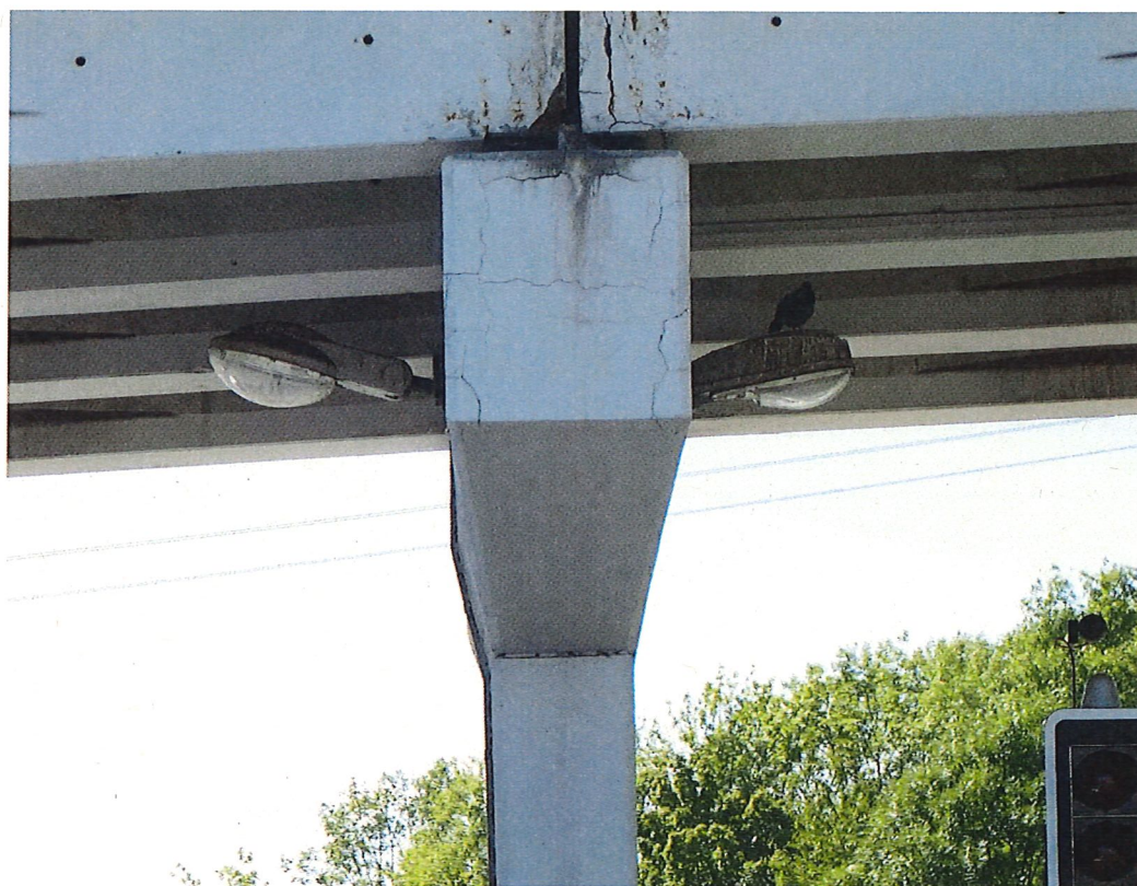
Figure 2-10 :: Dégradation de la tête de pile n°3
