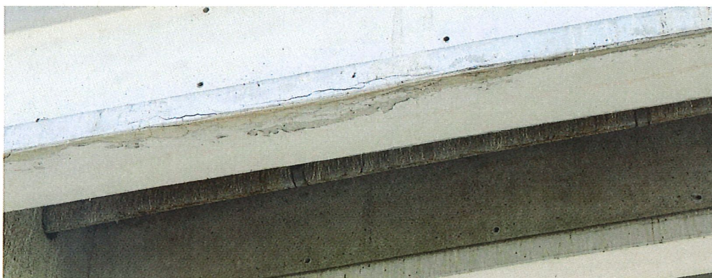
Figure 2-2 : Fissuration des poutres préfabriquées de bord
